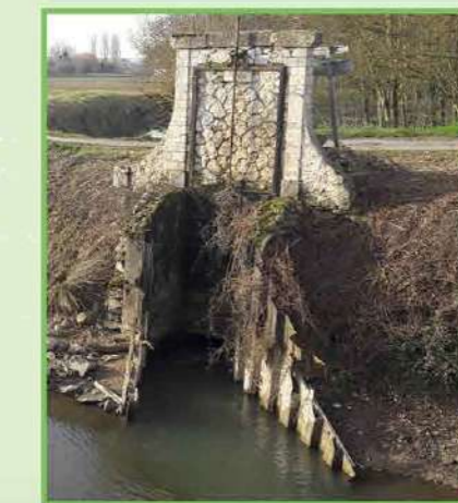
La vanne, juste en amont du pont, permet la réalimentation des cours d'eau et fossés quand le clapet est relevé.
