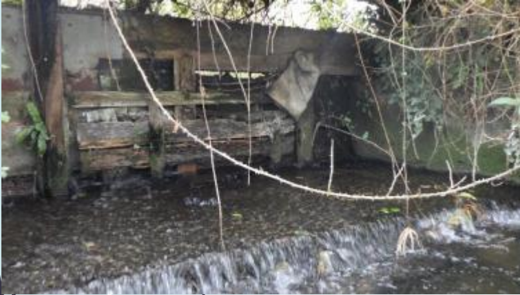
Vanne ouvrage de décharge
