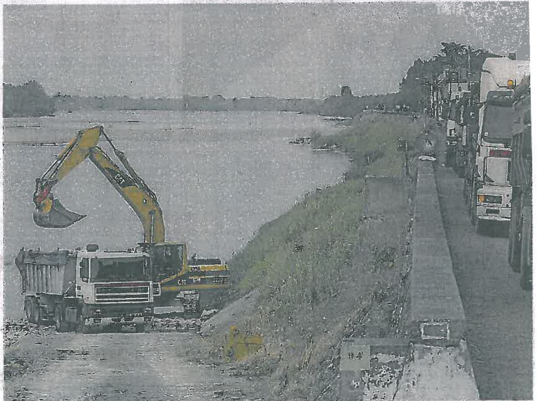
La Bohalle, mai 2002. Les derniers travaux de renforcement de la levée étaient l'œuvre de l'État. Qu'en sera-t-il demain ?
